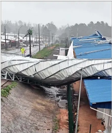
El techo de la escuela modular de Punta de Parra, construida tras los incendios del verano, se cayó producto del viento.
