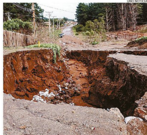
INFRAESTRUCTURA HA SUFRIDO DAÑOS SEVEROS EN TODA LA REGIÓN.
