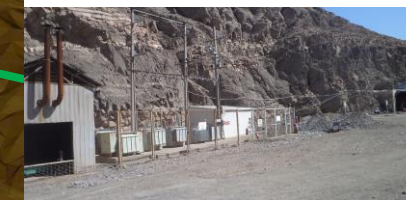
SSEE Meléndez 2.000 KVA
