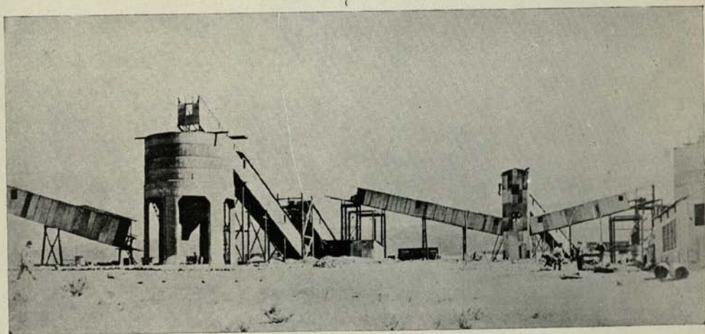
Caja de Crédito Minero.—Correas transportadoras de caliches de azufre y tolvas de almacenamiento en construcción (Ollagüe).
