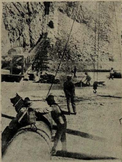
Andes Copper Co. (Potrerillos). Construcción de un plano inclinado para elevar una cañería
