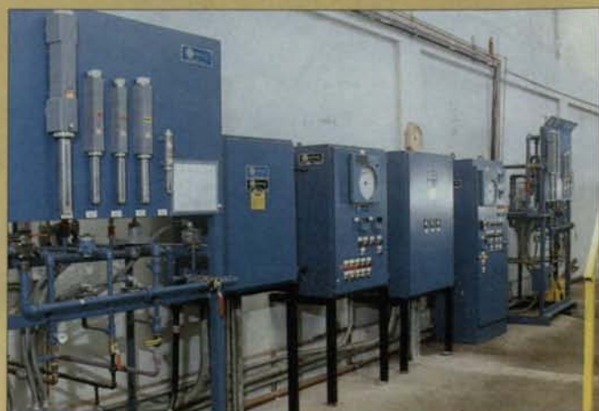
Vista parcial del tablero control de flujo de gases.
