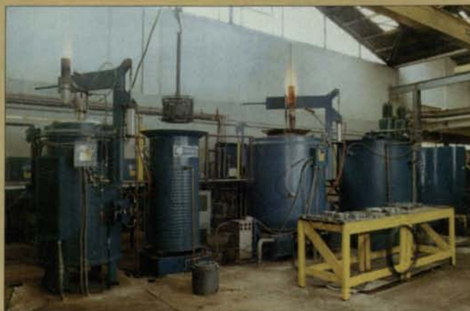
Vista general de Planta de Tratamientos térmicos por lecho fluidizado.
