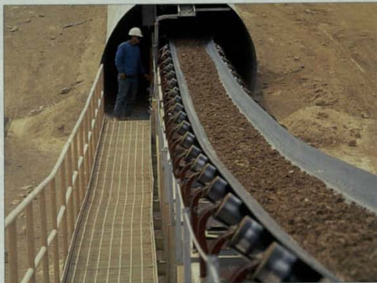
El relave filtrado es transportado por este sistema de correas hasta el sitio de deposición.
