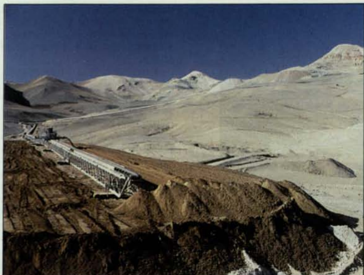
Depósito de relave seco, con distribución mecanizada por correa transportadora.
