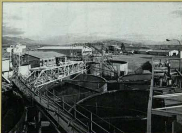
Espeadores para lavado a contracorriente en etapa de lixiviación Planta de Vallenar.
