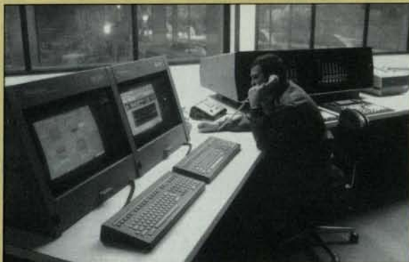
Sala de control de operaciones. División Salvador. Codelco Chile.
