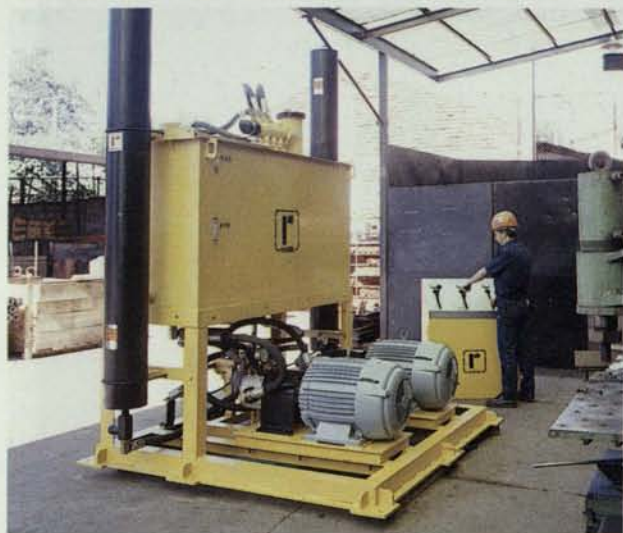
CENTRAL HIDRAULICA CON ACUMULADORES DE PISTON 180 HP.
