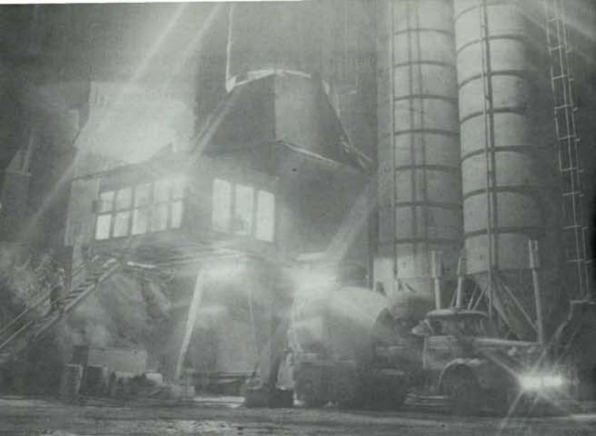
Trabajos en zona de la central hidroeléctrica que servirá para la caída del agua.
