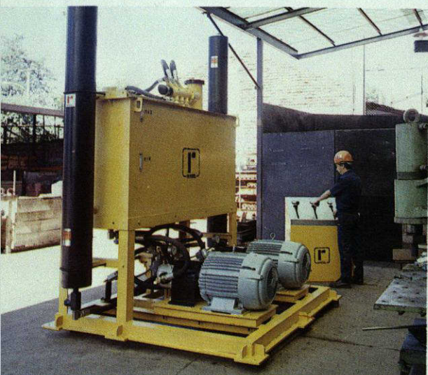
CENTRAL HIDRAULICA CON ACUMULADORES DE PISTON 180 HP.
