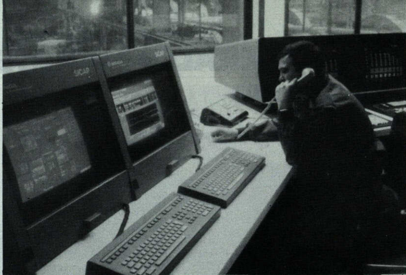
División Salvador. Sala de control de operaciones de la concentradora.
