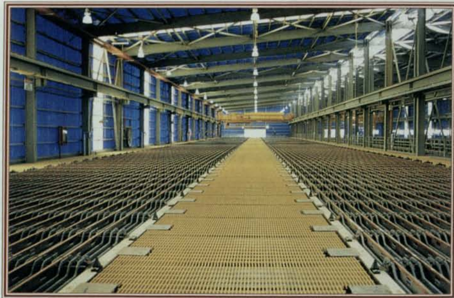
La nave de electro-obtención está constituida por 680 celdas. Tiene una capacidad de diseño de 225 mil toneladas de cátodos de cobre por año.
