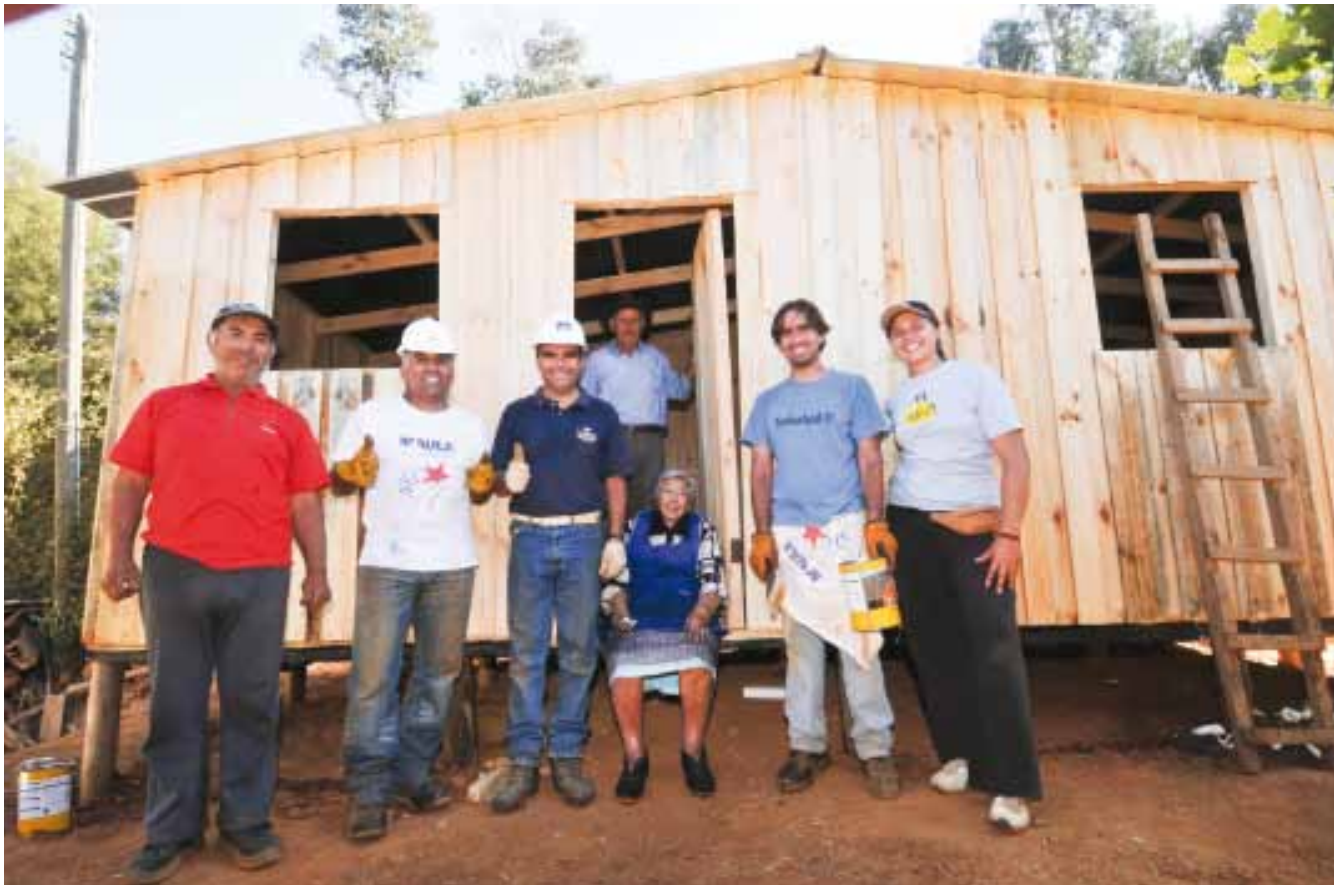
Voluntarios de Barrick colaboran en las tareas de construcción de casas de emergencia.
